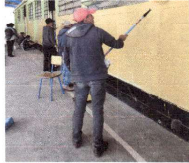
Foto 2: Pintura en paredes
